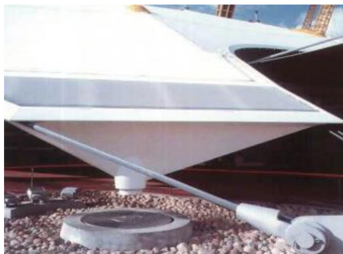
Vue de l'entrée du système de stockage des eaux de pluies
